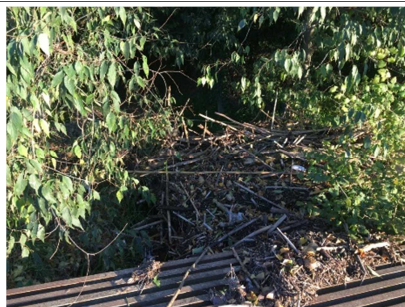
Acumulació de deixalles i restes vegetals al desguàs.
