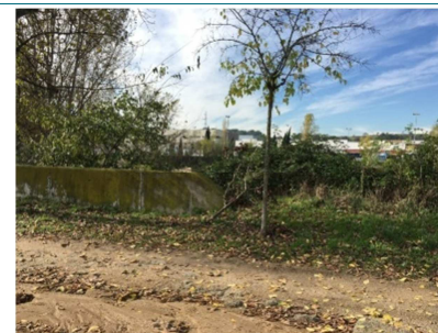
Mur parcialment enderrocat.
